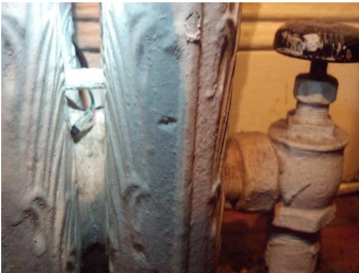
Рисунок 3. Датчик температуры на батарее
